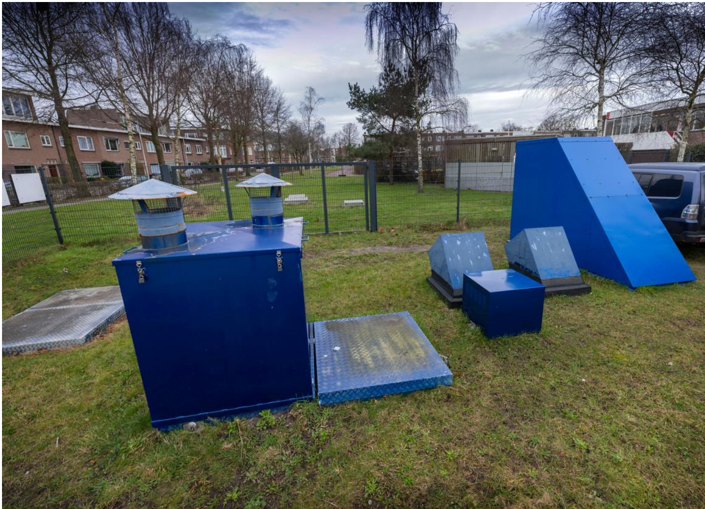
De waterzuiveringspompinstallatie aan de rand van het Griftpark. Mogelijk is die op termijn uit te zetten als de bacteriën hun opruimende werk goed doen. Beeld Werry Crone
